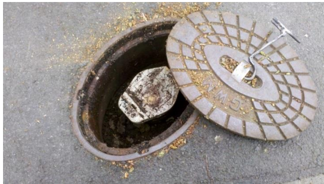
Abb. 18: Grundwassermessstelle in der Straßendecke (Quelle: LANUV NRW)
